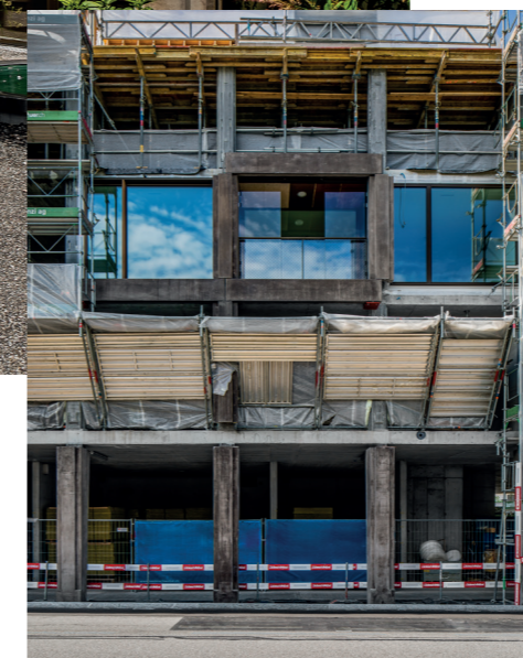
Diese 1:1-Musterfassade wurde extra von der MÜLLER-STEINAG ELEMENT AG erstellt, während der Rohbau auf der Baustelle weiter seinen Lauf nahm. Bauherrschaft und Architekten erhielten so die Gewähr, dass das Fassadenbild zuletzt auch wirklich den Vorstellungen entsprach.
